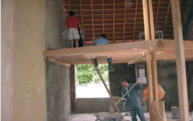
Chantier de réhabilitation de la ferme maraîchère de Saint-Denis conduit par APIJ BAT dans une démarche d'écoconstruction. Photo : ARENE
